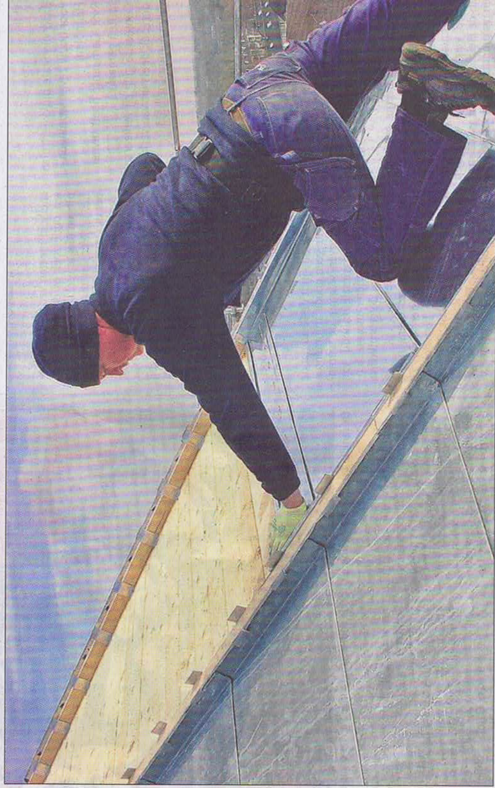
Na het verwijderen van het oude dak van de watertoren, bleek het dakbeschot ernstig aangetast door zwam. Nadat dit helemaal was vervangen, kon het zinken dak worden gelegd dat het ondergelegen hout weer vele jaren zal beschermen.
